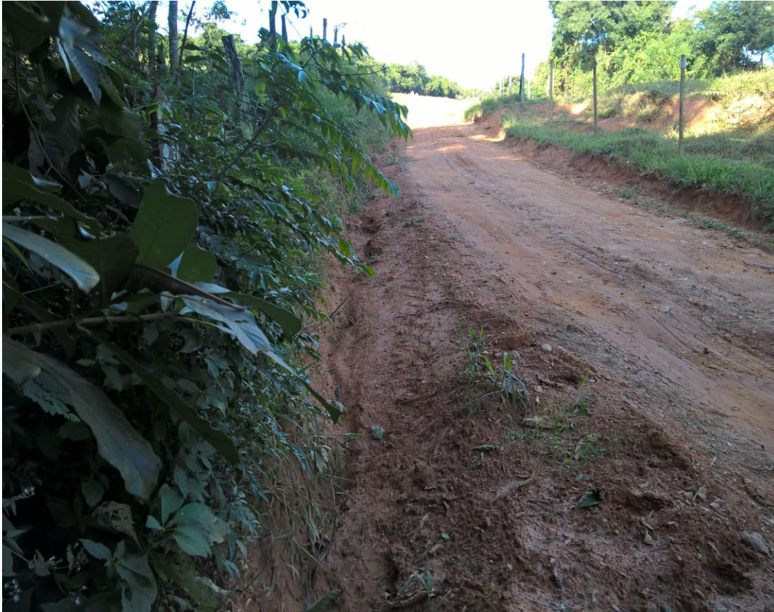
Registro de assoreamento vindo do acesso para a Nascente 12
