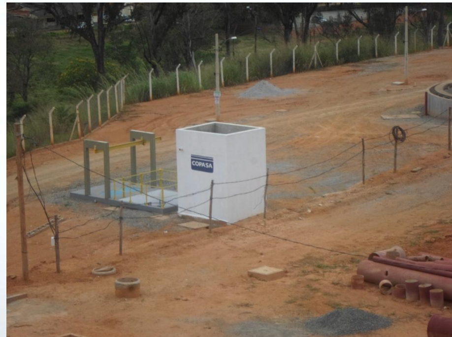
Elevatória de recirculação
